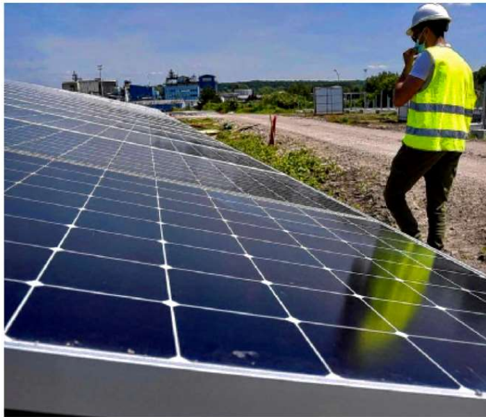
Plusieurs centrales photovoltaïques sont en projet en Picardie maritime, sur des friches industrielles. Elles devraient ressembler à celle-ci, qui vient d'être livrée dans l'Oise.
